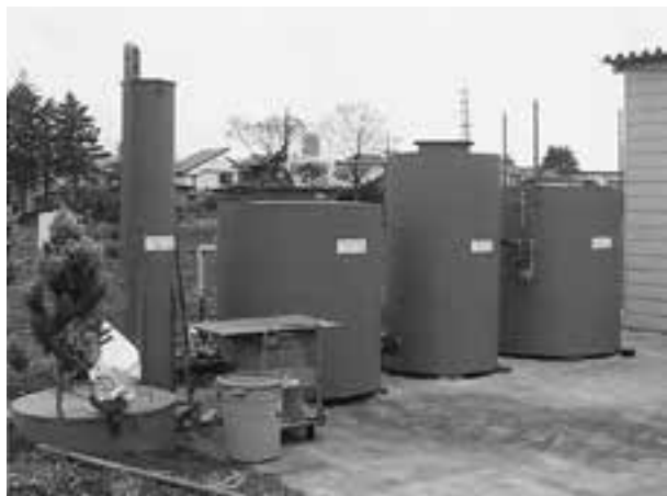
図4 設置したメタン発酵装置
