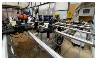
Fig. 2 養液供給システム
